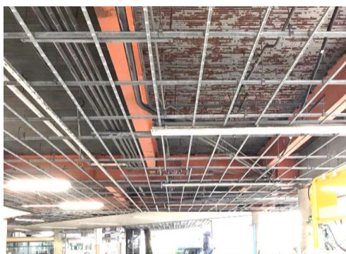
軒裏パネル取付金具の劣化
