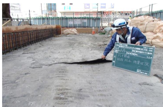
防水層の劣化
