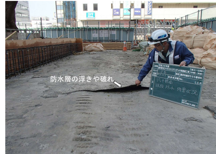
防水層の劣化
