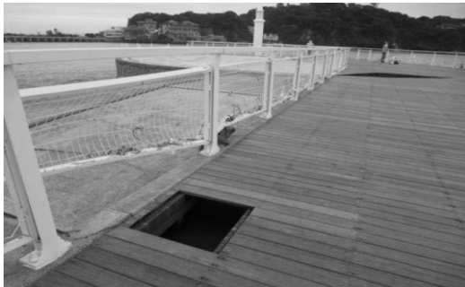
西防波堤転落防止柵損壊の状況 (先端部)
