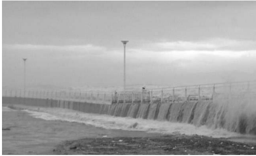
西防波堤越波の状況 (陸域より撮影)
