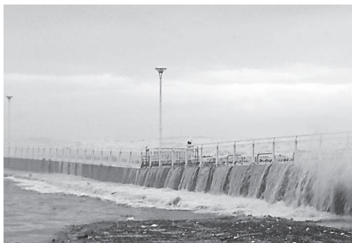
(平成29年台風第21号による越波状況)
