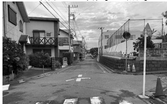
村岡106号線【ひび割れ】
