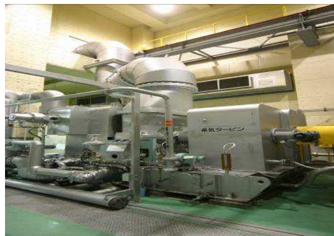
【蒸気タービン & 発電機】
