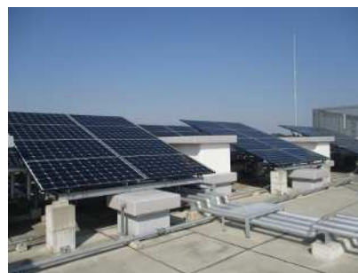
【藤沢市民病院に導入した太陽光発電システム(20 kW)】
