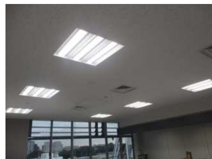
【市役所本庁舎に導入した LED 照明】
