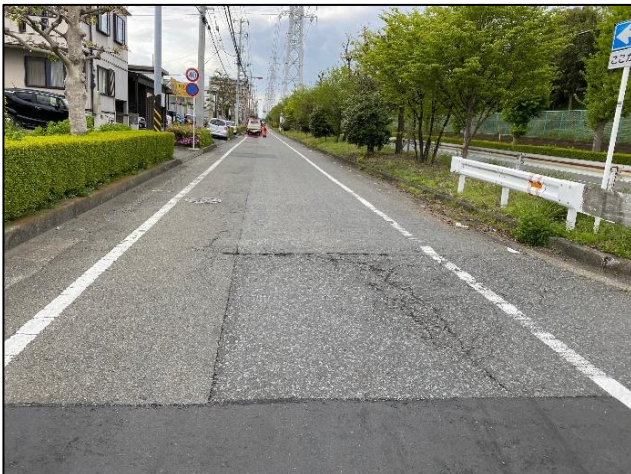
桐原町石川線（ひび割れ）
