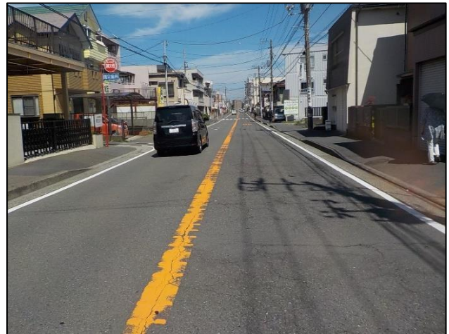
藤沢羽鳥線（ひび割れ）
