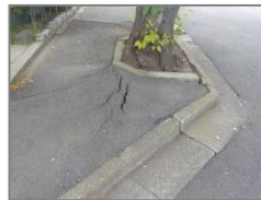
【道路舗装への影響】
