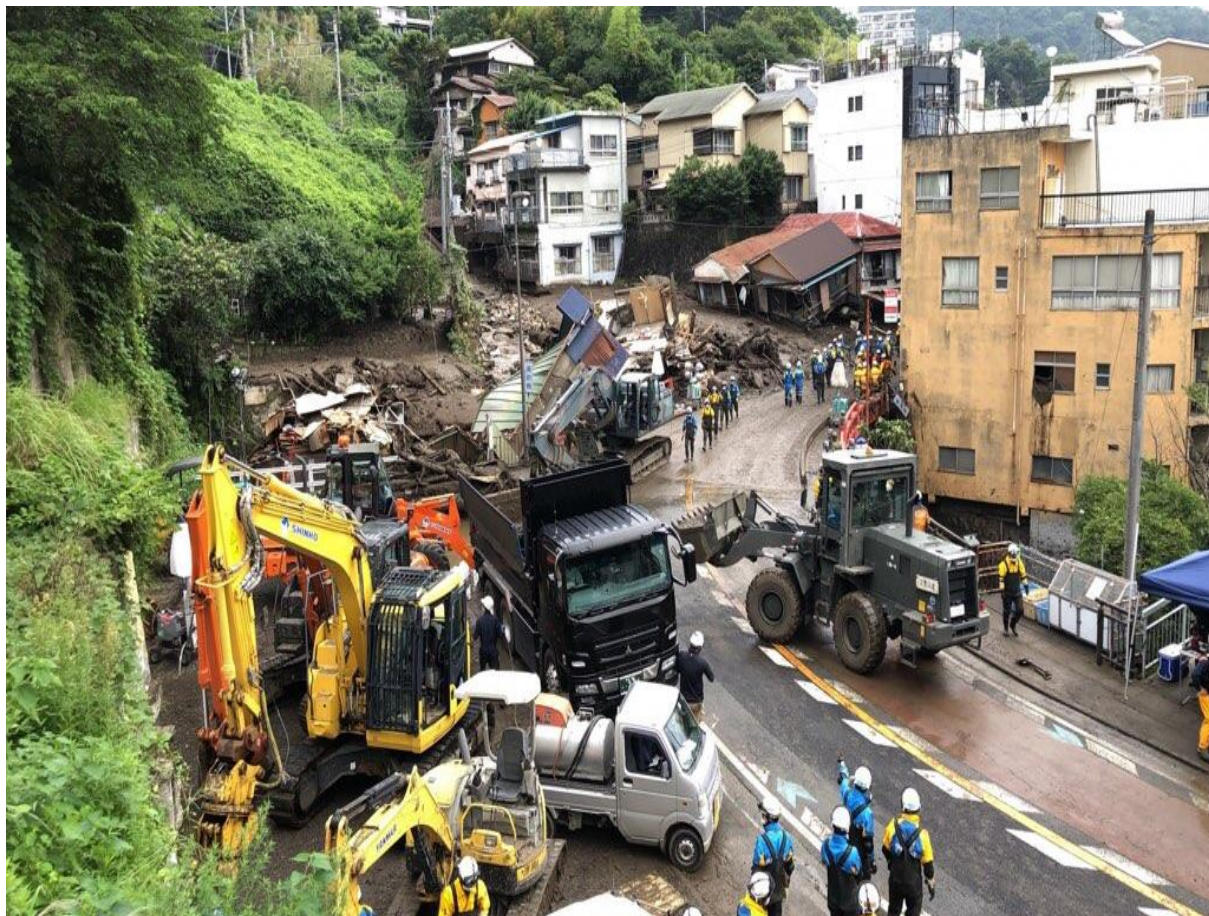
活動現場付近の被災状況
