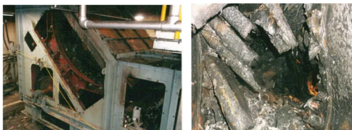
火災事故により損傷した不燃ごみベルトコンベア（平成 28 年度）
