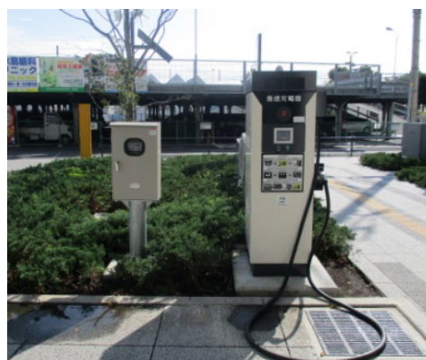
◆市役所本庁舎の電気自動車用急速充電器
