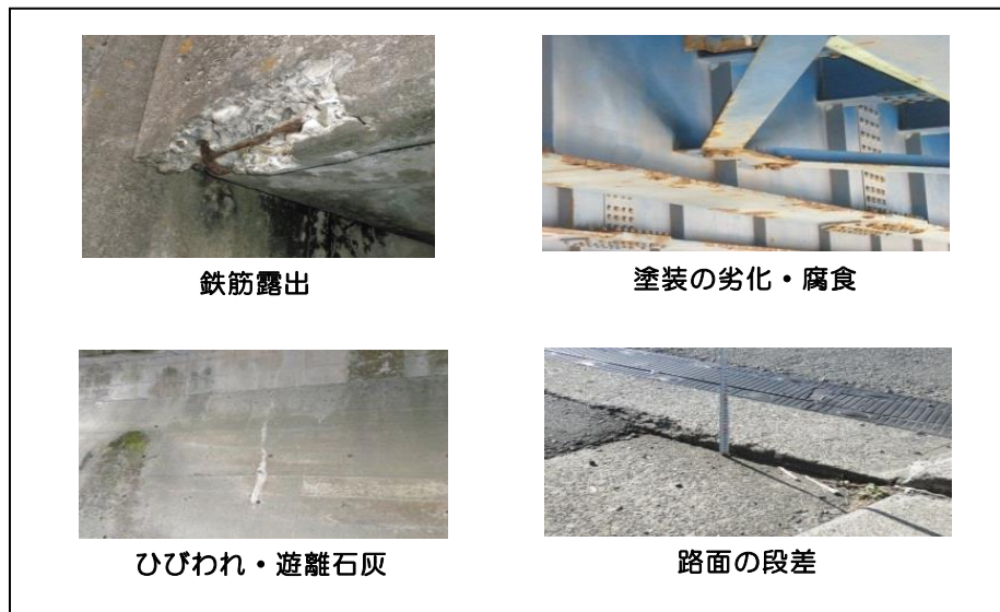
図 4 - 5 橋りょう の損傷例
