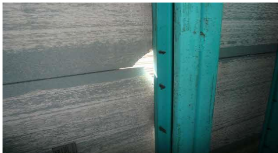
藤沢駅北口自転車等駐車場（大規模修繕対象） ※状況：外壁のパネル全般に反りが生じ、端部には欠損が発生
