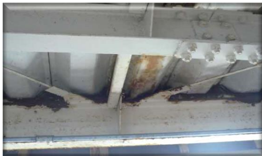
鶴沼海岸駅自転車等駐車場屋根腐食箇所（下面） ※状況：長年の雨漏りにより主要構造部に腐食が発生
