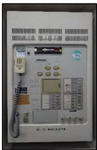
非常放送用設備
