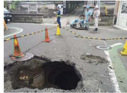
【管きよ老朽化に起因する道路陥没】 遊行寺前 2016（平成 28）年 9 月
