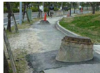
【マンホール浮上】 東日本大震災の浦安市の事例 2011（平成 23）年 3 月
