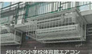
刈谷市の小中学校体育館エアコン
